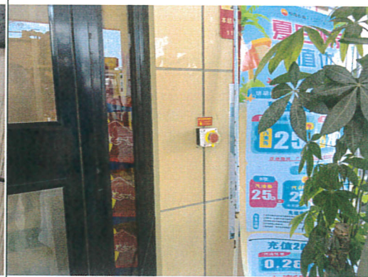
站房外墙紧急按钮
