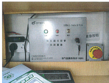
双层油罐双层油管在线渗漏监测系统 紧急切断按钮
