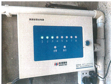
双层油罐双层油管在线渗漏监测系统
