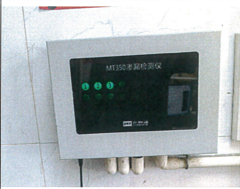
油罐—油管在线渗漏监测系统
