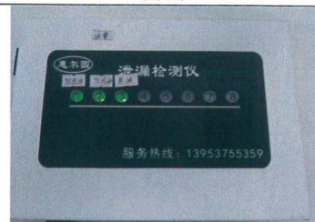
油管在线渗漏监测系统
