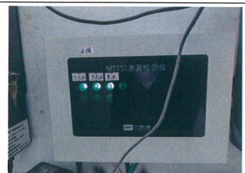
油罐在线渗漏监测系统
